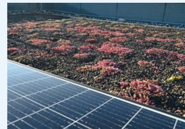
Dachbegrünung und PV-Anlagen für ein besseres Klima
