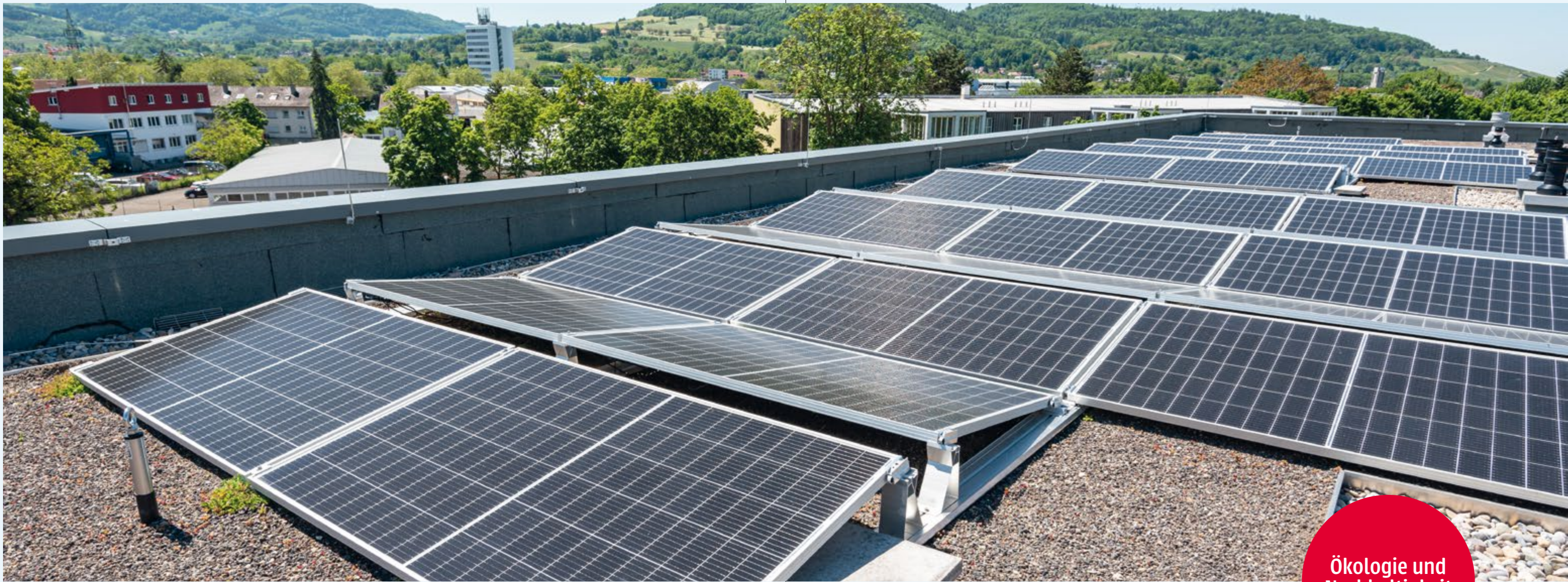
Photovoltaik-Anlage auf dem Dach eines Wohngebäudes im Quartier Schildacker
