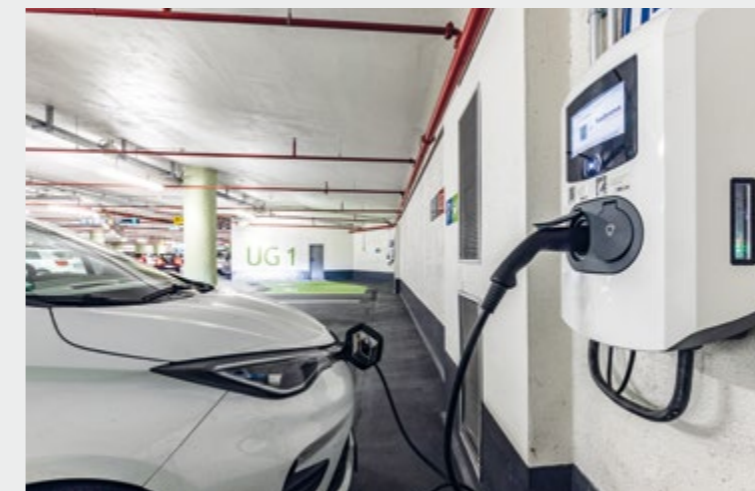
Neue E-Ladestationen in der Rotteckgarage
